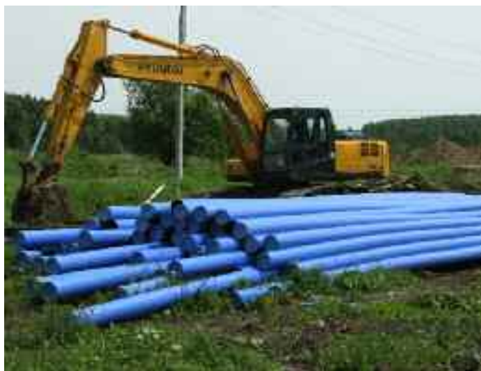
Трасса канализации от дер. Березовка до очистных сооружений гор. Богородск Нижегородской обл., Ø 315 мм длиной 10 км
