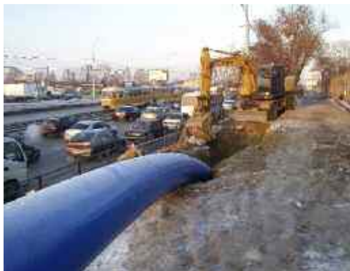
г. Екатеринбург, ул. Донбасская. Протект Ø 500, протяженность 10000 м. Заказчик «Водоканал». Восстановление водопровода методом протяжки с разрушением ветхой стальной трубы, 2011 г.
